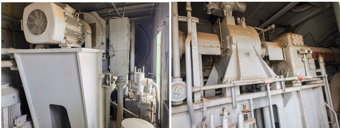
Auxiliary system of 9E/9E 的辅机系统
